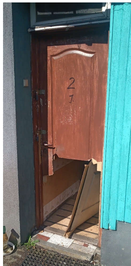
drzwi klasy RC1/RC1 sforsowane akumulatorową „flexą”
