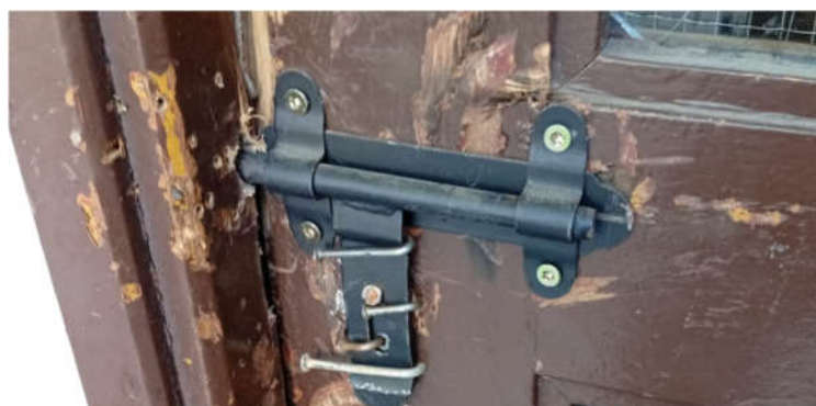
obiekt powłamaniowy prowizorycznie zabezpieczony przez załogę patrolową podczas interwencji
