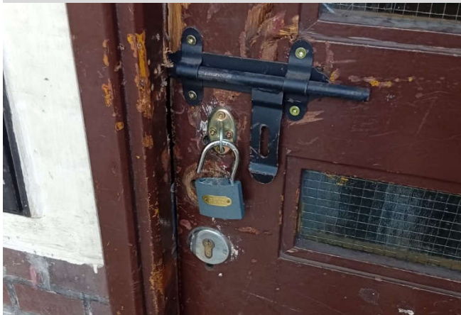
zerwana kłódka z dystansu maskująca włamanie, zasuwą otwartą – sprawcy mogą nadal być wewnątrz obiektu
