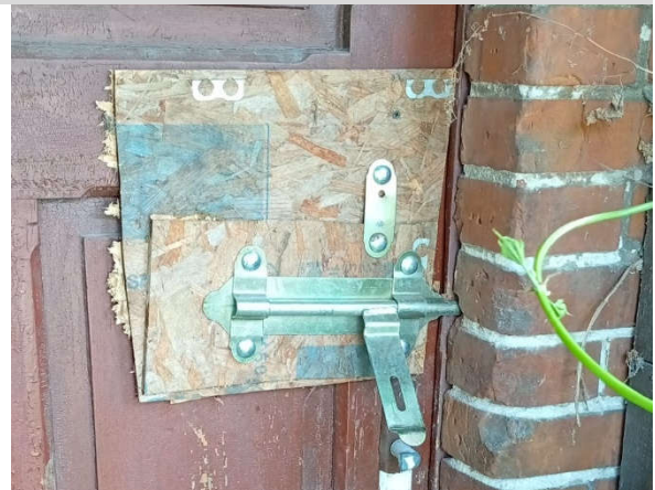
zerwana kłódka, zasuwą zamkniętą – obiekt bezpieczny, choć sprawcy zapewne planują powrót
